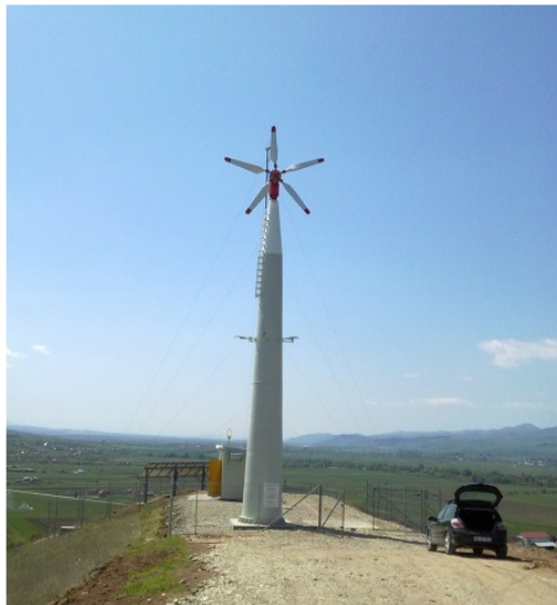
Fig. 2.47 Turbina de vânt și containerul (în spate) cu instalațiile aferente, montate pe amplasament.
